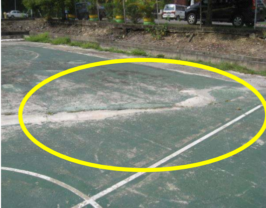
Gambar 4.3 Lantai Gelanggang Bola Keranjang Retak Dan Berlubang
