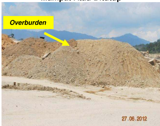
Gambar 3.3 Bahan Tanah Berlebihan Yang Tidak Di Mampat Atau Ditutup
