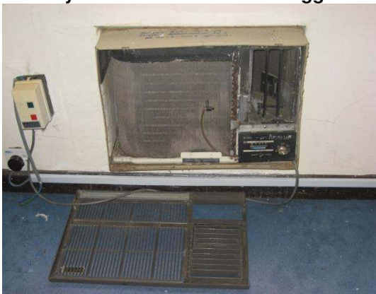
Gambar 6.14 Penyaman Udara Tidak Di Senggara
