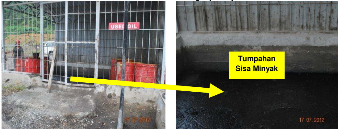
Gambar 3.10 Stor Penyimpanan Bahan Minyak Tidak Mempunyai Sistem Saliran Dan Perangkap Minyak
