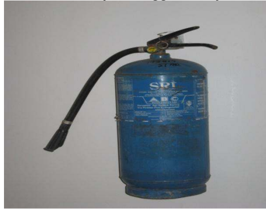
Gambar 6.6 Alat Pemadam Api Tidak Ada Pelekat Tarikh Luput Penggunaannya
