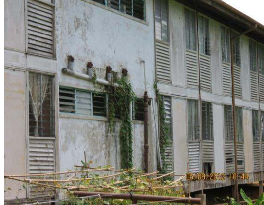
Gambar 6.17 Kuarters Kakitangan Tidak Di Senggara
